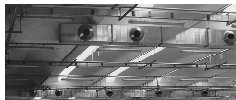
Exemple d'application dans un bâtiment industriel
